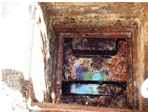
Photo 1 : Exemple de boîte à graisse d'un restaurateur
