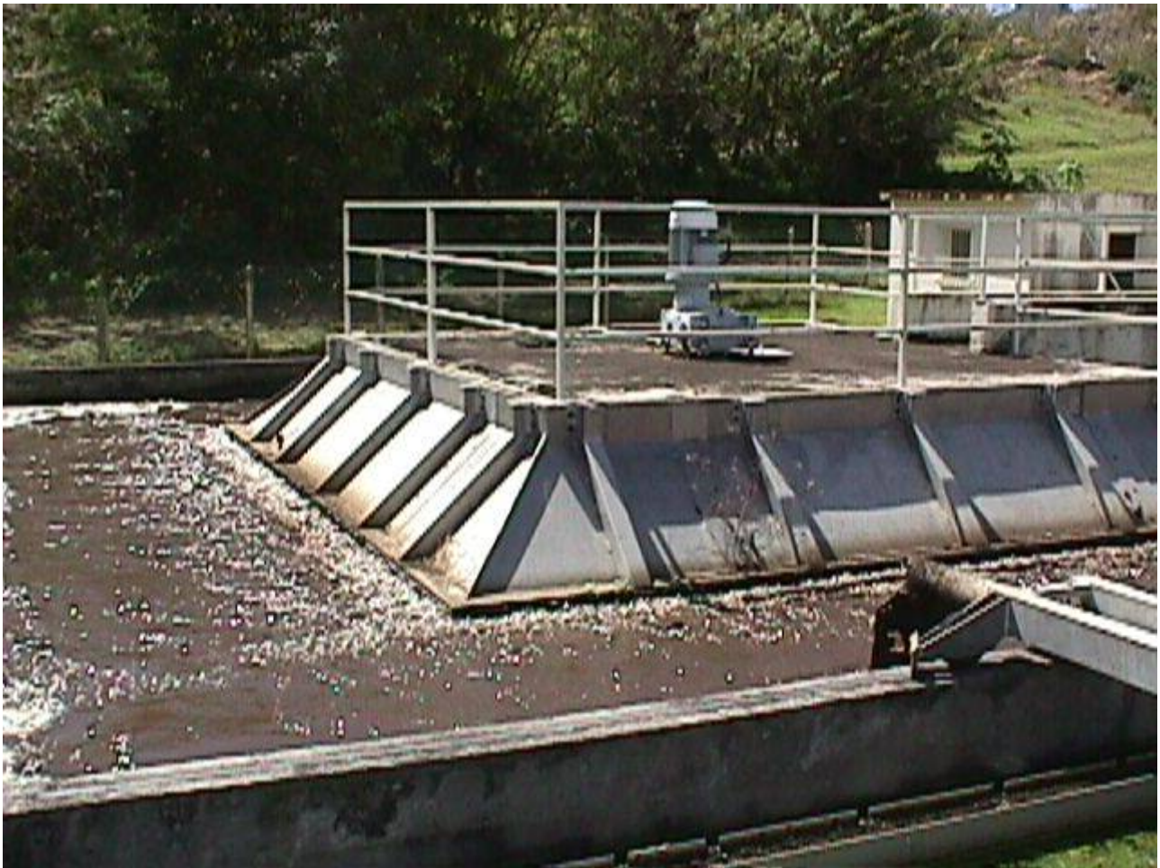
Station de traitement d'eaux usées de DIZAC
