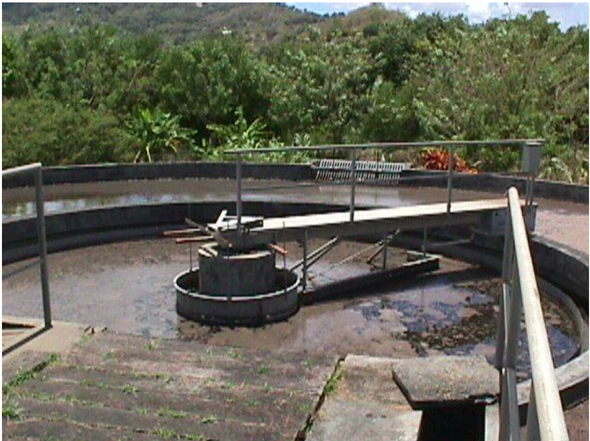
Station de Traitement d'eaux usées du Bourg
