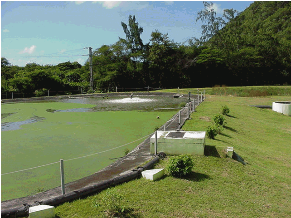
Station d'eaux usées du bourg
