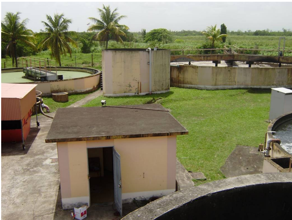
Station de traitement d'eaux usées du bourg. -Bassin d'aération -
